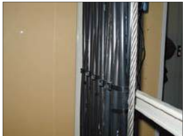
건물 내 수직 케이블
